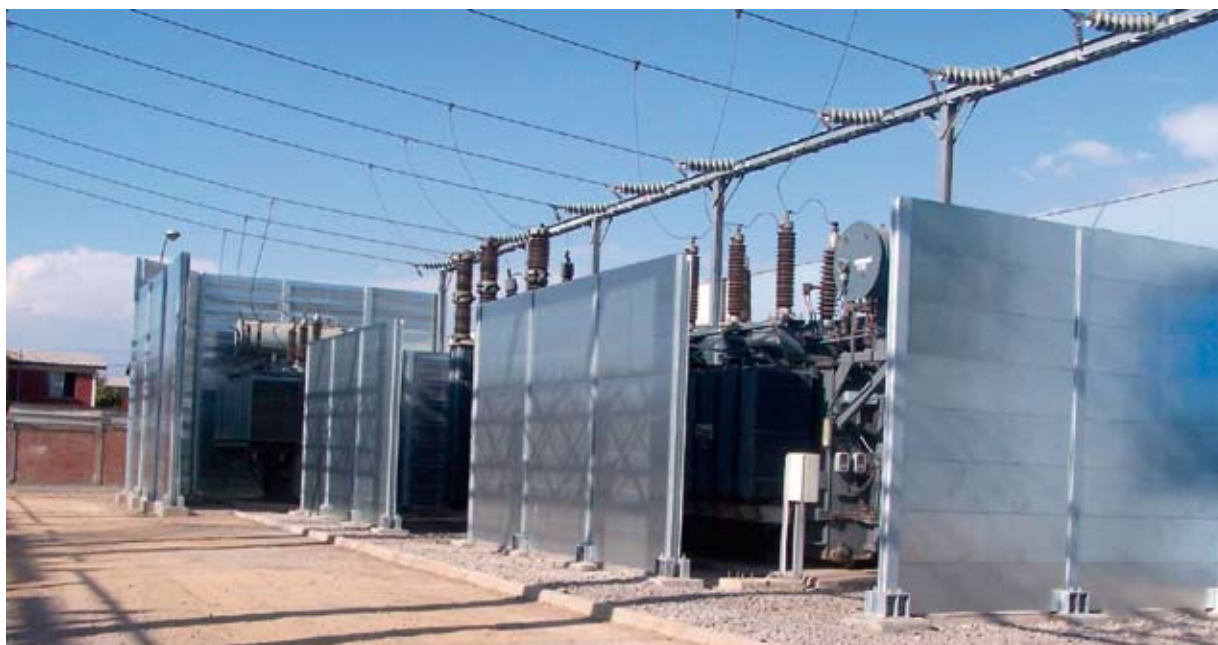
Pantallas acústicas en la subestación Macul.
