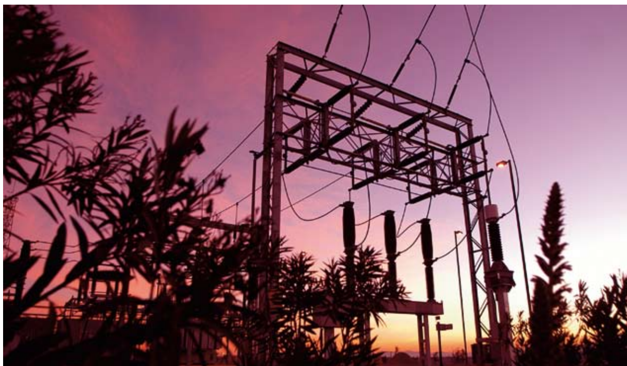
Subestación Santa Elena
