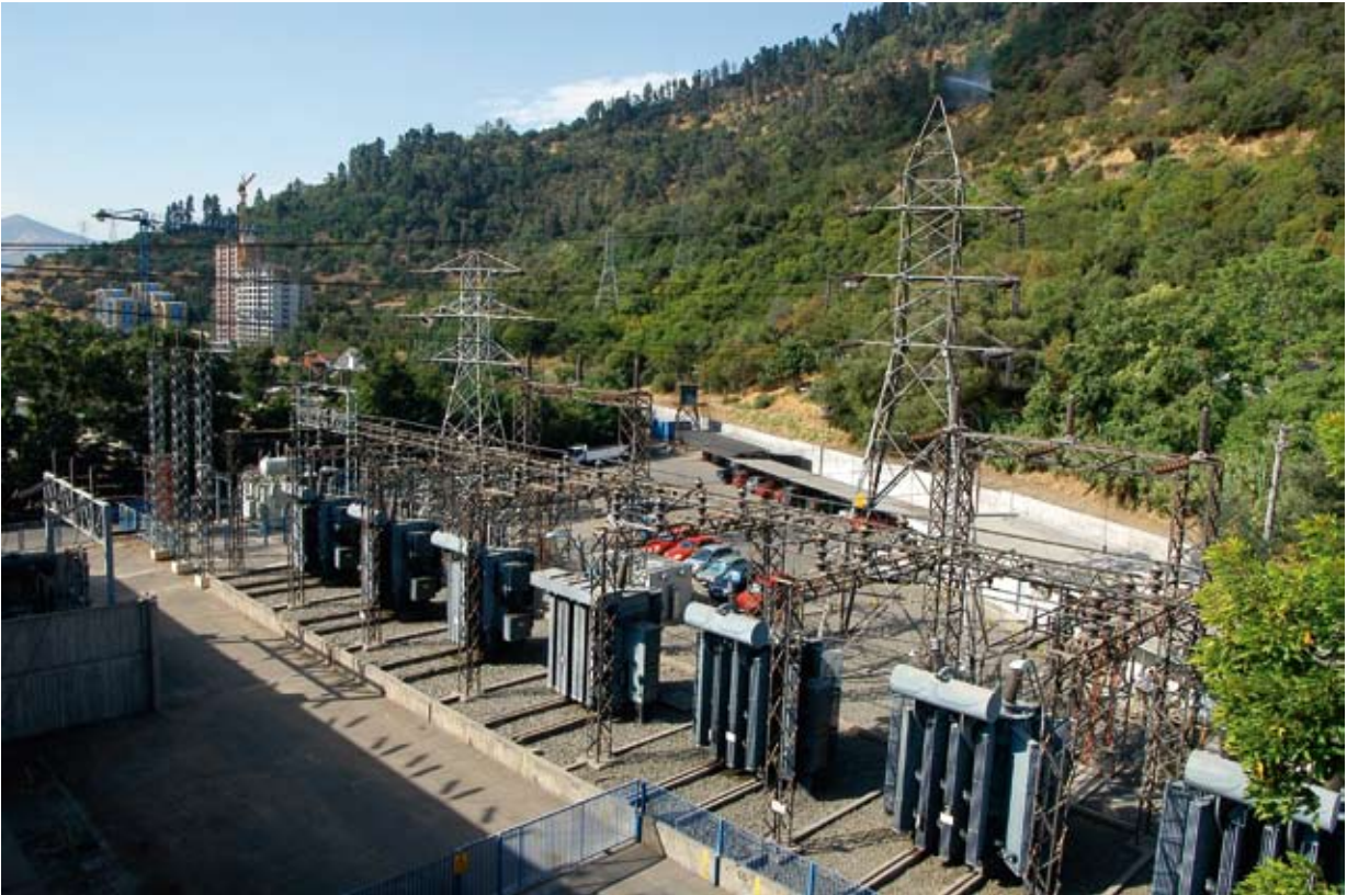
Subestación San Cristóbal.
