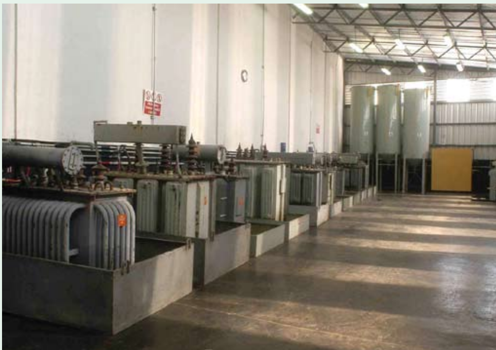
Decoloración en Subestación eléctrica de Edesur, Argentina.
