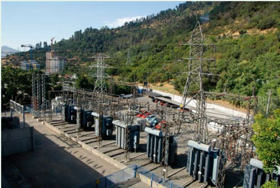
Subestación San Cristobal, Santiago, Chilectra.
