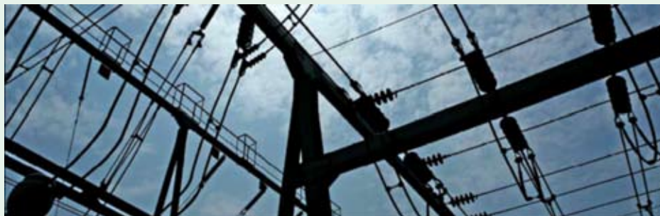
Subestación Chavarría (Los Olivos) - Lima.
