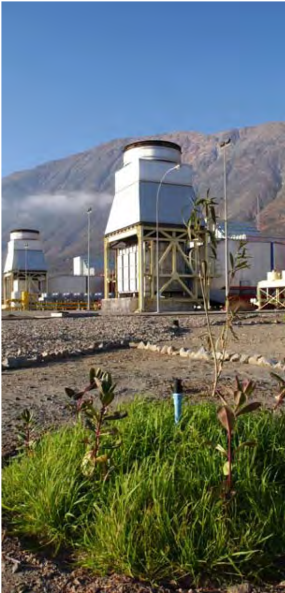
Central térmica Taltal, Chile.
