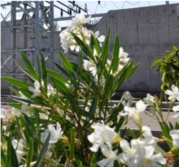
Subestación Los Dominicos
