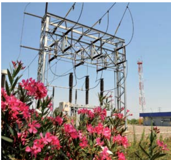
Subestación Santa Marta
